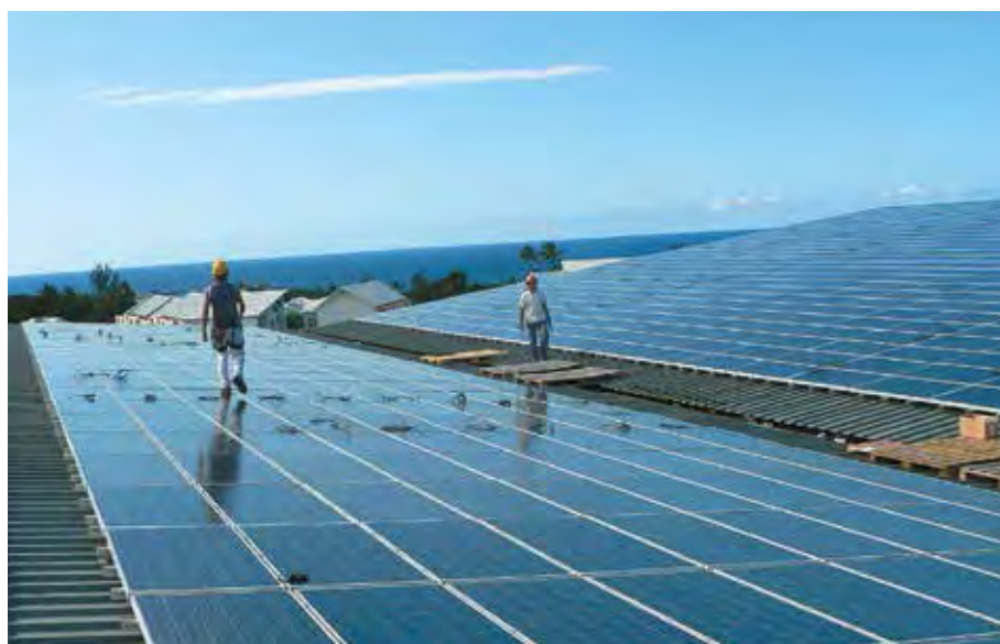
La Réunion. Toiture photovoltaïque. Lycée Bel Air à Sainte-Suzanne. © Aérowatt
