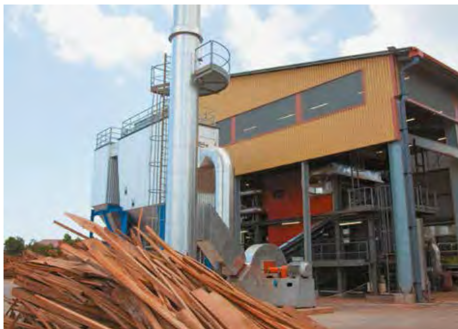
Guyane. Centrale biomasse Voltalia à Kourou. © Ronan Liétar - ADEME
