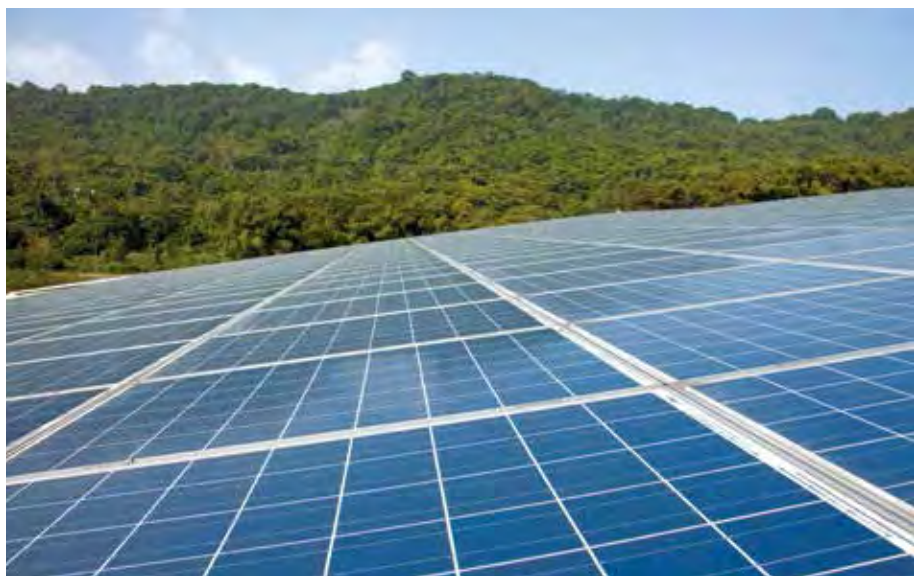
Guyane. Générateurs photovoltaïques – ADEME © Ronan Liétar
